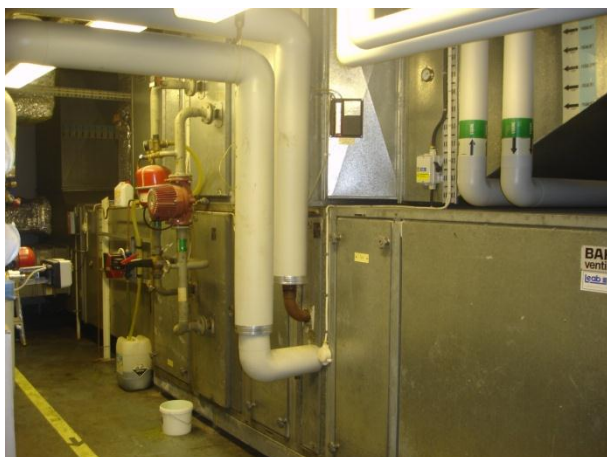
Figur 7. Ventilationsaggregat för högdelen.
