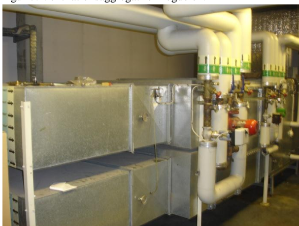
Figur 8. Ventilationsaggregat för lågdelen.
